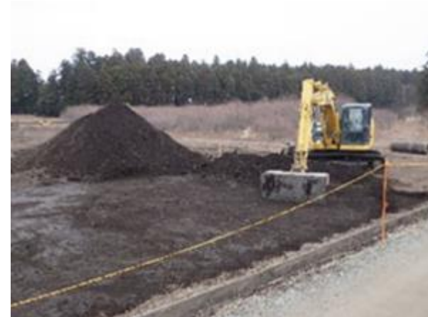
特定復興再生拠点区域での農地除染工事の様子 (福島県富岡町)
